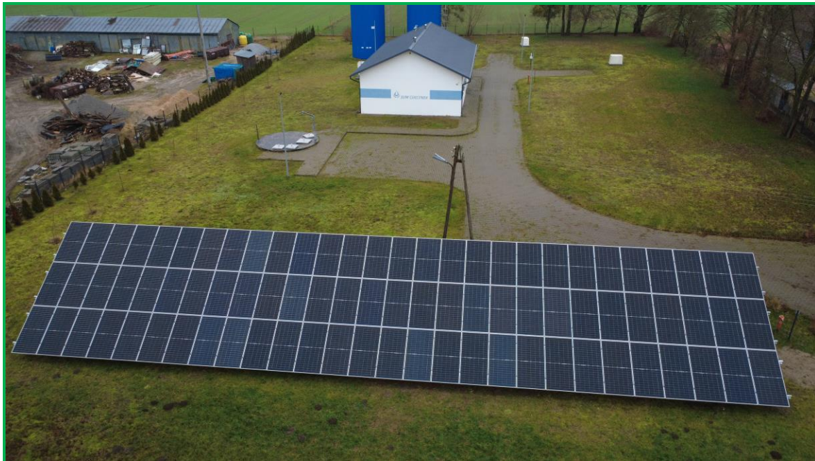
Instalacja OZE na SUW w Cekcynku – fot. UG w Cekcynie
